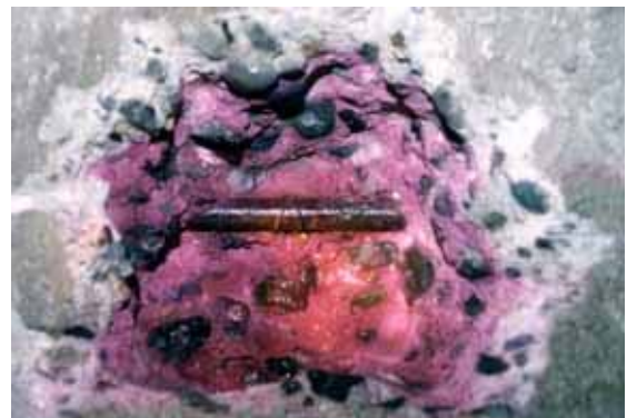
写真-9 赤く変色した腐食鉄筋周辺のコンクリート
