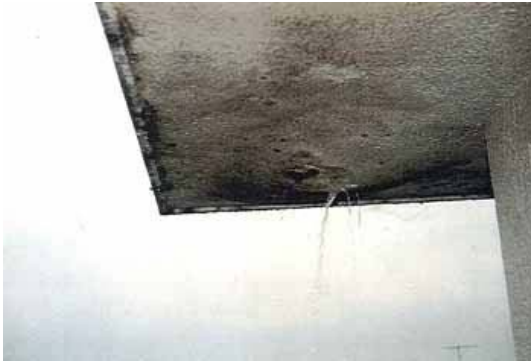
軒天の塗膜のふくれ
