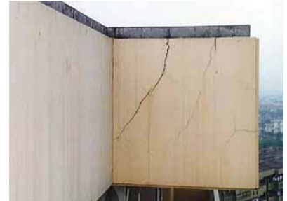
パラペット廻りのひび割れ
