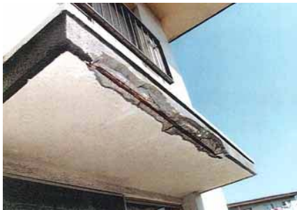
庇軒天はなさきのコンクリート剥離
