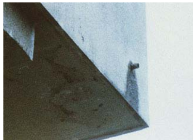
庇の排水パイプによる汚染
