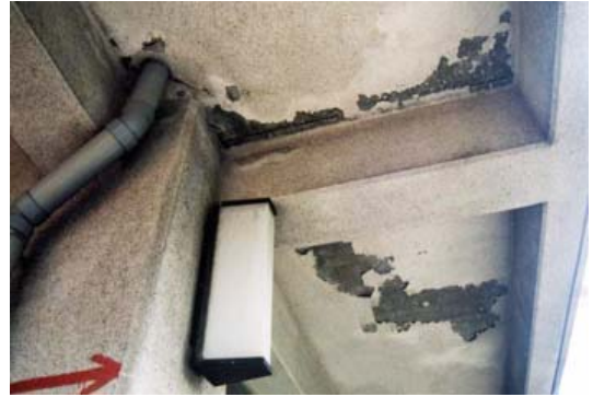
軒天の塗膜のめくれ
