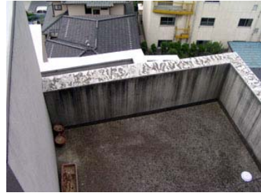
腰壁天端の雨垂れ汚れ
