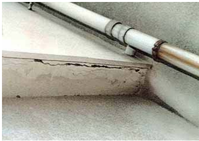
屋階段差部のひび割れ
