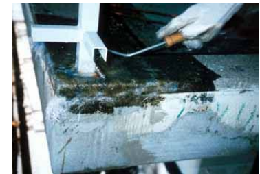
ひび割れしやすい取合い部
