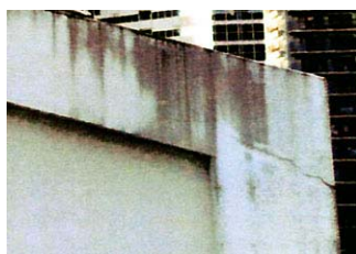
外壁柱型のひび割れ
