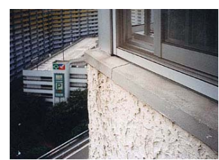
窓台のモルタル故障
