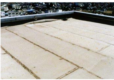
築 10 年程度のマンションで、立ち上がり部に生じた防水層の膨れた。
