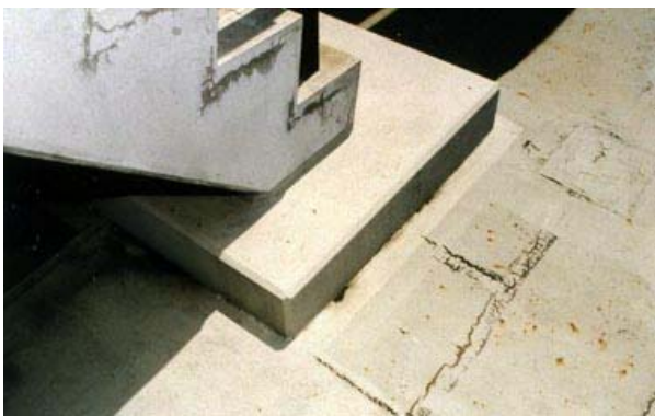
屋上にある階段の基壇まわりに亀裂が生じている。
