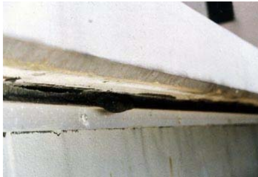
アスファルト系シーリング材が熱によって軟化し、だれや空洞が生じた。
