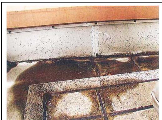
側溝に面した防水立ち上がり部に膨れや破損が生じていた。
