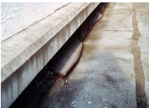
防水立ち上がり部の著しい膨れ。押さえ金物のシーリング材が充てんされておらず、雨水が浸入して防水層にたるみが生じた。
