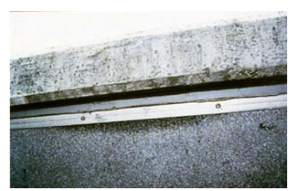
変成シリコン系シーリング材で補修した箇所もあった。ただし、コンクリート表面がアスファルトに汚染されている箇所でははく離が生じていた。
