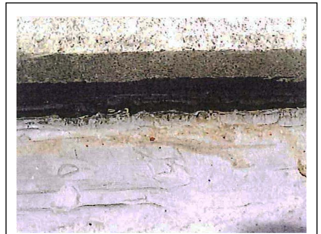
土間が載っている際の部分でアスファルト防水層 が切れている。
