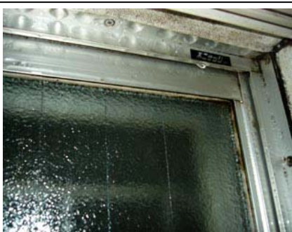
断熱不足と換気不足により、アルミサッシに著しい結露が生じている。
