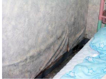
結露によって壁のクロスがはがれ、カーペットにカビが生じていた。
