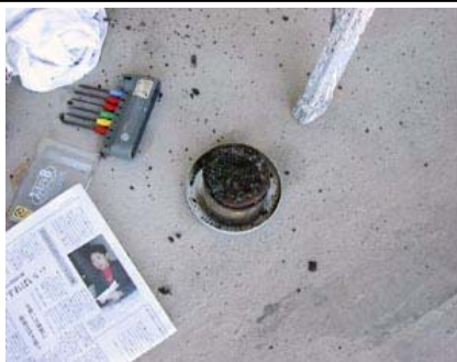
取り外した換気口に汚れが付着し、防虫網が目詰まりしている。
