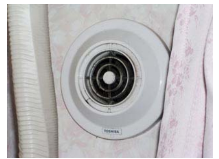
寝室の換気扇にカビが付着している。音がうるさくて止められてしまったと思われる。
