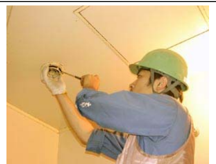
浴室換気扇の吸い込み口カバーを取り外す。内部まで入念な清掃が必要である。
