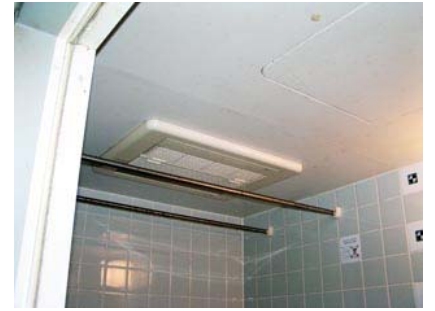
浴室換気扇は、住戸全体の結露解消に有効なのだが、ここでは結露を防げなかった。
