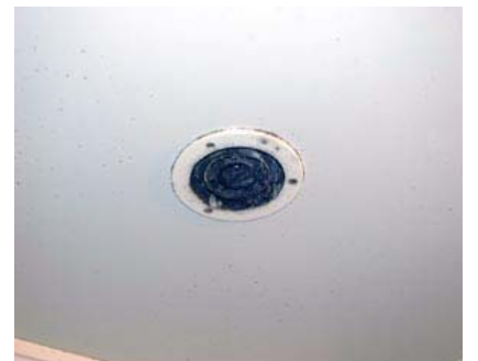
浴室換気扇吸い込み口がほこりでふさがっている。内部が清掃されず、排気不足の原因となっている。
