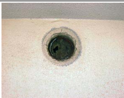
排気口の9割が排煙や紛じんでふさがっている。換気口の役割を果たしていない。
