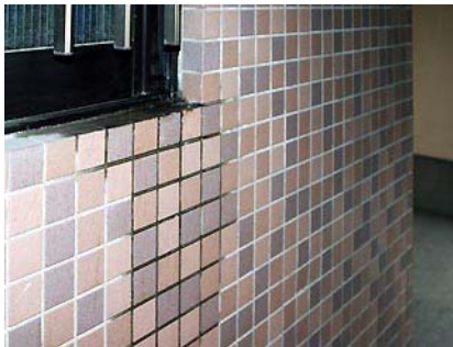
窓サッシから流れ出た結露水が外壁を伝って流れる。
