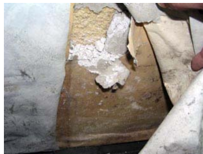
外盤には、発泡ウレタンによる断熱処理が施されているにもかかわらず、結露が生じていた。
