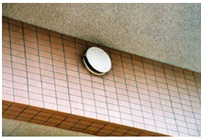
換気口に逆流防止の風除け板が設けられている。
