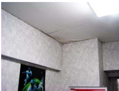
結露によって天井や壁の入り隅部のクロスがめくれたり、はがれたりしていた。
