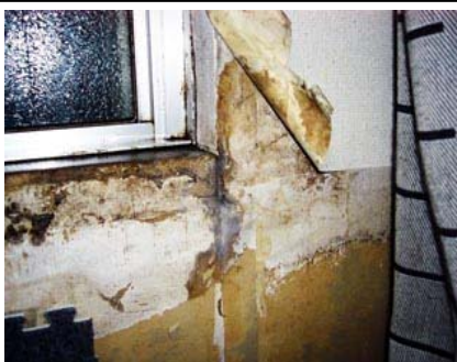
窓まわり仕上げ材が結露により雑がられている。ボードの下地コンクリート表面に結露水が流れている。
