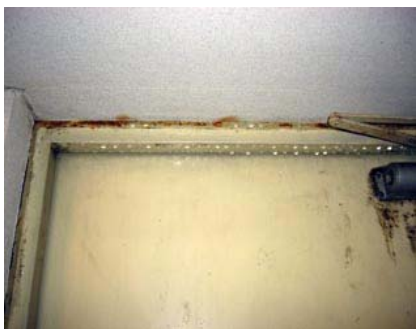
玄関扉に著しい結露が生じている。枠埋め込みまわりに■やカビが生じている。
