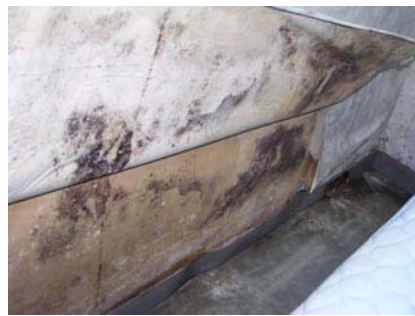
壁クロスの背面にまで、結露によるカビが生じていた。
