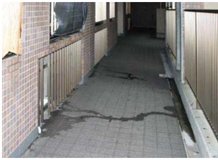
結露水が窓サッシから流れ出て廊下の床まで垂れている。
