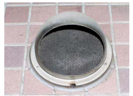
換気口防虫網が完全に目詰りしている。定期清掃が必要である。
