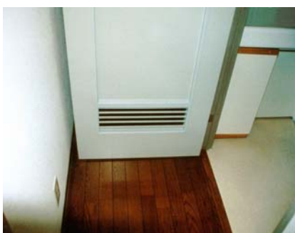
脱衣場のドアに換気ガラリがついている。
